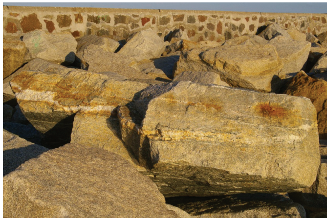
Ryc. 11. Duży blok granitu strzegomskiego na falochronie – widoczna żyła kwarcu, liczne spękania i strefy żazelazienia
